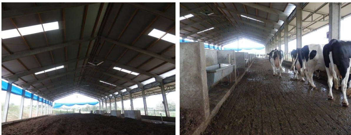
Figura 1. Exemplo de sistema de confinamento compost barn e suas estruturas: cama onde ocorre o processo de compostagem, muretas de contenção, presença de ventiladores e cortinados, passagem para pista de alimentação (esquerda), muretas de proteção para bebedouros, pista de alimentação e bebedouros voltados para pista, com comedouros externos cobertos (direita). Local: Chapecó, Santa Catarina.
